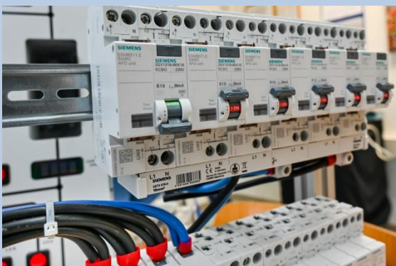
Steuerungstechnik in der Elektrotechnik
